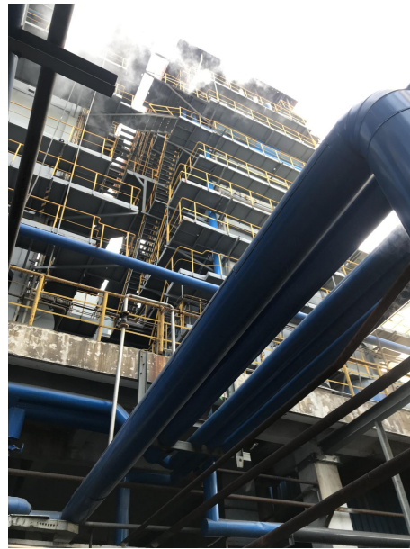
图 4-3 2#锅炉处理设施照片
