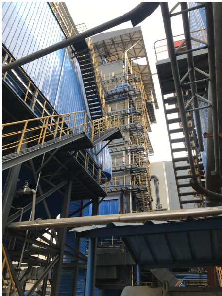
图 4-2 1#锅炉处理设施照片
