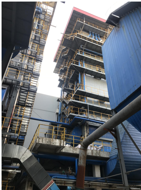
图 4-4 3#锅炉处理设施照片
